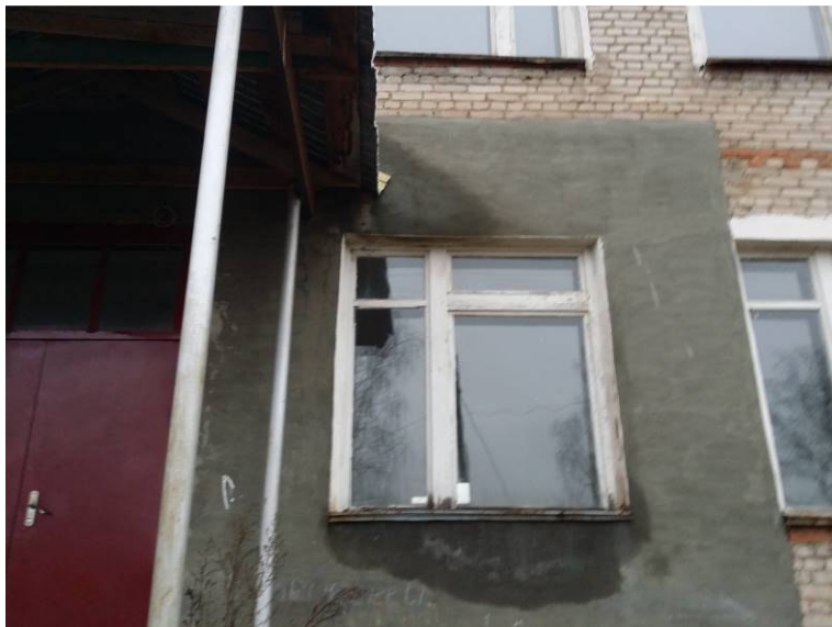
Рис. АС-4 Следы намокания стены в месте примыкания кровли входной группы к стене в осях 2-3/А
