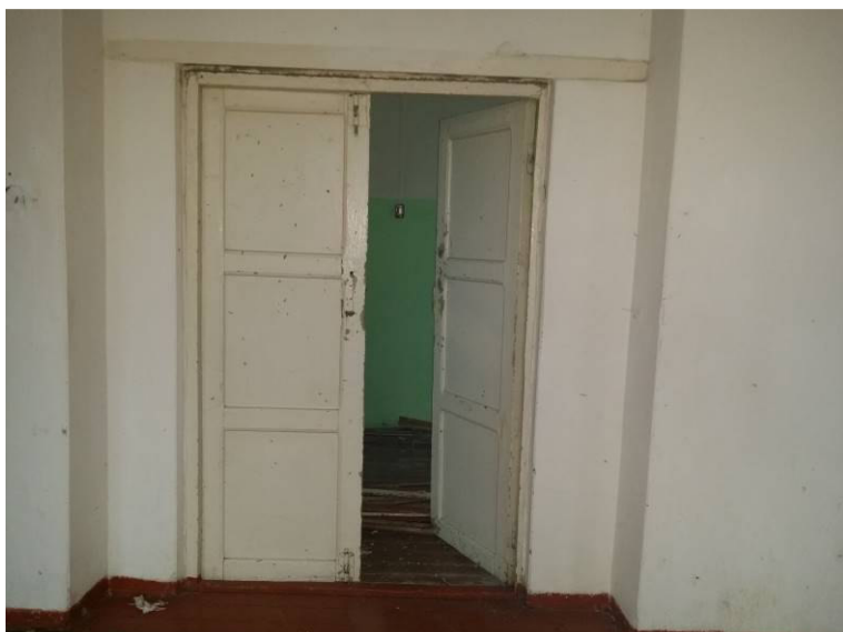
Рис. АС-23 Дверные блоки в здании построечного изготовления. Все дверные блоки имеют механические повреждения.
