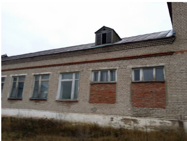
Рис. АС-8 Фасад в осях 1/Г-А: частично заложены оконные проемы. Отделка цоколя имеет следы разрушения.
