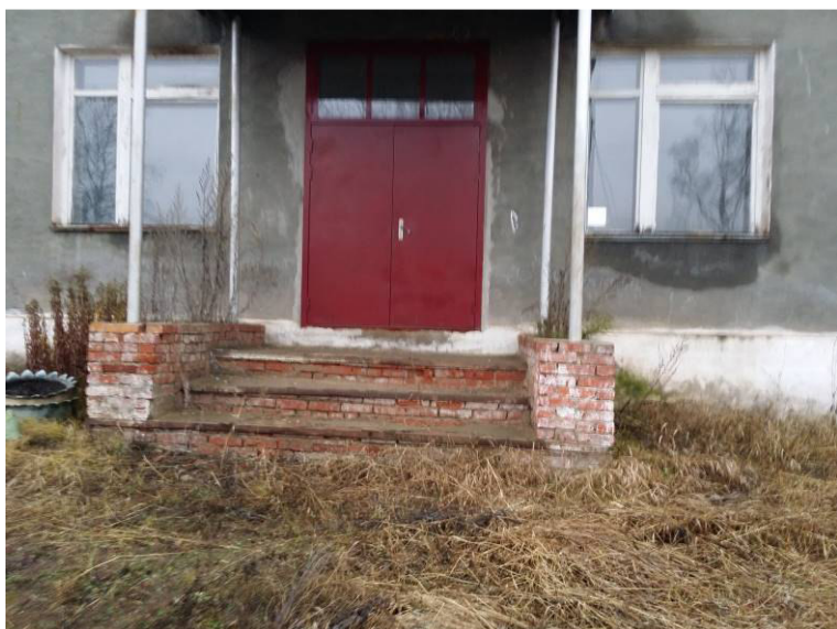
Рис. АС-3 Входная группа в осях 2-3/А. Деструкция каменной кладки на глубину до 30мм.
