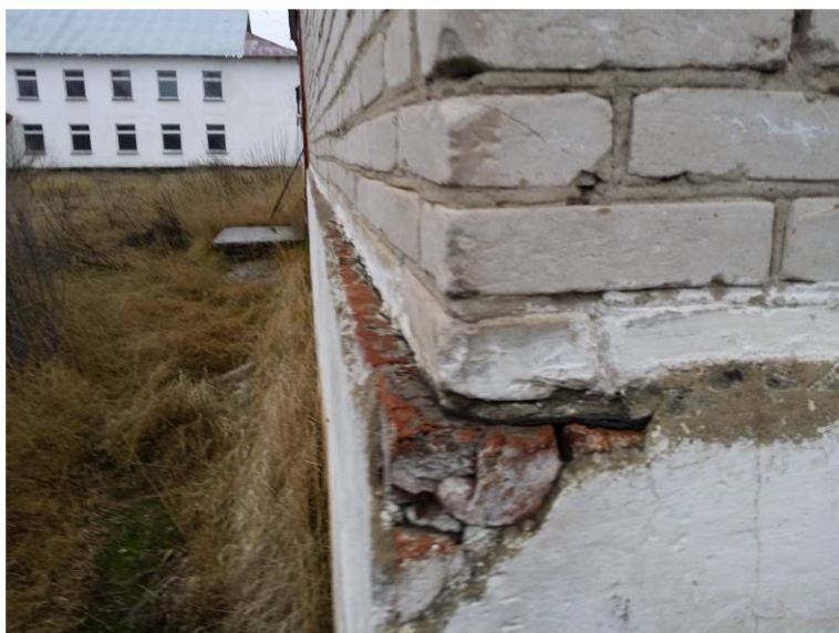
Рис. АС-6 На отм. 0,000 выявлена горизонтальная гидроизоляция из 2х слоев рубероида. Ниже отм.0,000 кладка из керамического полнотелого одинарного кирпича.
