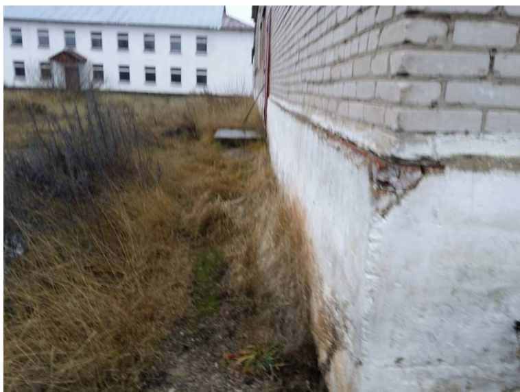
Рис. АС-5 Отмостка по периметру здания имеет механические повреждения, частично находится под слоем земли
