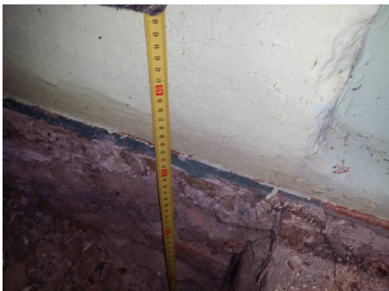
Рис. АС-27 Результат вскрытия пола первого этажа
