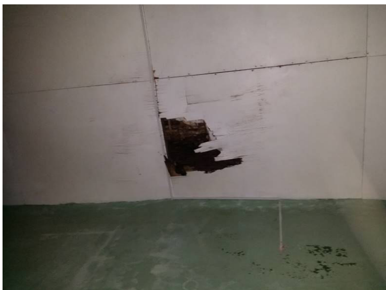
Рис. АС-18 Подшивной потолок над спортзалом в осях 3-4/В-Г имеет следы биологической коррозии
