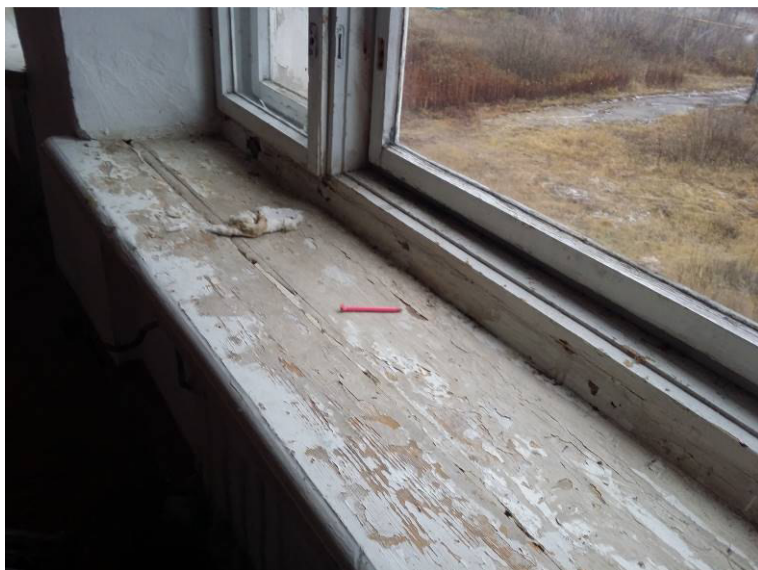
Рис. АС-24 Оконные блоки деревянные с отдельными переплетами. Часть остекления отсутствует.
