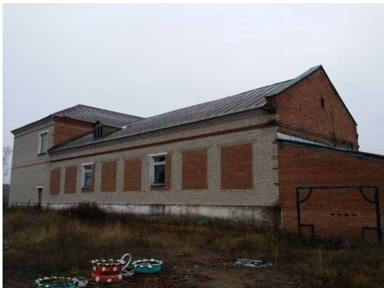
Рис. АС-16 Фасад в осях 4/А-Г: часть оконных проемов заложено.
